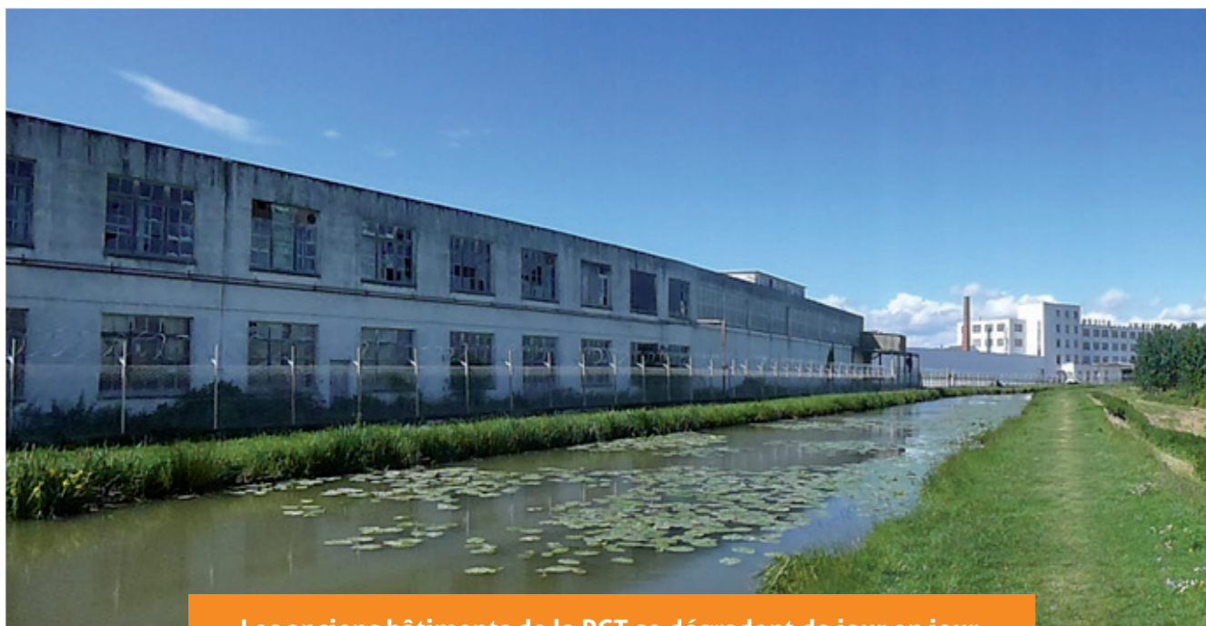
Les anciens bâtiments de la PCT se dégradent de jour en jour.
